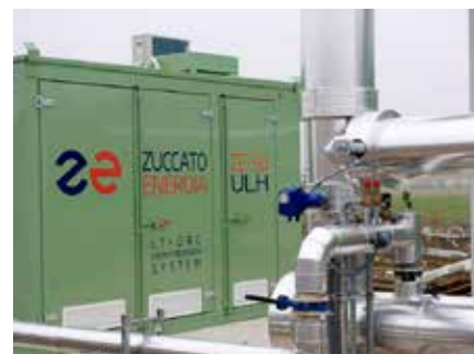
Borgoforte (MN) - Recupero termico da camicie e fumi di scarico di gensets a biogas
