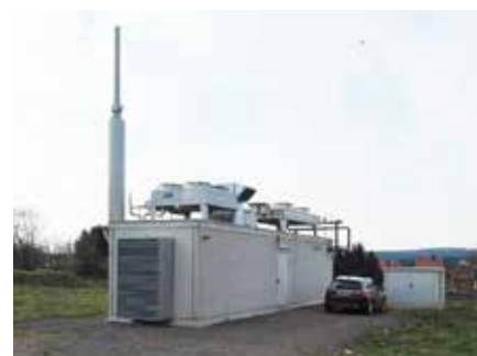
Benneckestein (Germania) - Recupero termico da camicie e fumi di scarico di gensets a biogas
