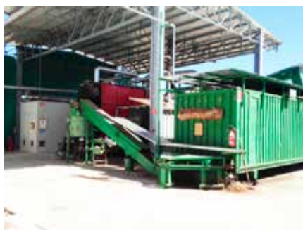
Sommalombardo (VA) - Produzione elettrica da caldaia alimentata a biomassa (scarti di segheria)
