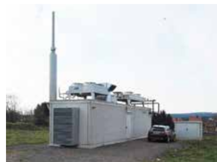
Benneckstein (Germania) - Recupero termico da camicie e fumi di scarico di gensets a biogas
