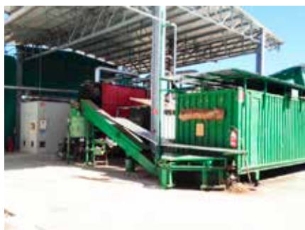
Sommalombardo (VA) - Produzione elettrica da caldaia alimentata a biomassa (scarti di segheria)
