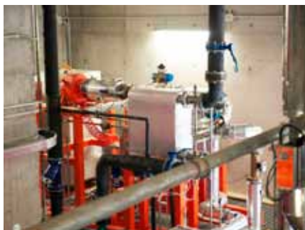
Mestre (Veneza, Itália) - Recuperação de calor de caldeira de biomassa e turbinas de ar quentes
