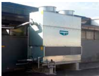
Unidade de torres gêmeas sem silenciadores
