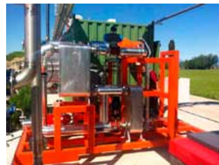
S. Pietro in Gu (Padova, Itália) - Recuperação de calor a partir de jaquetas de refrigeração e escapamentos dos motores a biogas
