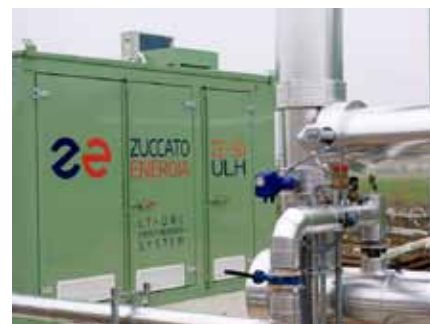
Borgoforte (Mantova, Itália) - Recuperação de calor a partir de jaquetas de refrigeração e escapamentos dos motores a biogas
