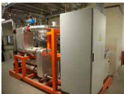
Meran (Bolzano, Itália) - Recuperação de calor a partir de jaquetas de refrigeração e escapamentos dos gaseificadores e motores a syngas
