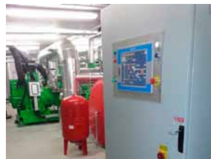
Morgex (Aosta, Itália) - recuperação de calor a partir de jaquetas de refrigeração e escapamentos dos motores a óleo vegetal
