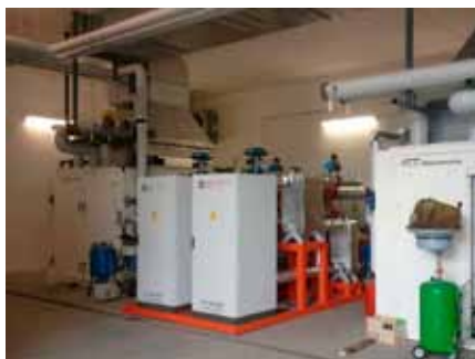
Renon (Bolzano, Itália) - recuperação de calor a partir de jaquetas de refrigeração e escapamentos dos motores a óleo vegetal
