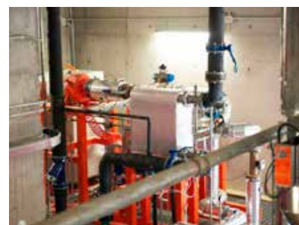
Mestre (VE) - Recupero termico da caldaia a biomassa e da turbine ad aria calda
