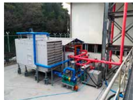
Heuksan (Corea del Sud) - Recupero termico da centrale termoelettrica (generatori ad olio pesante)
