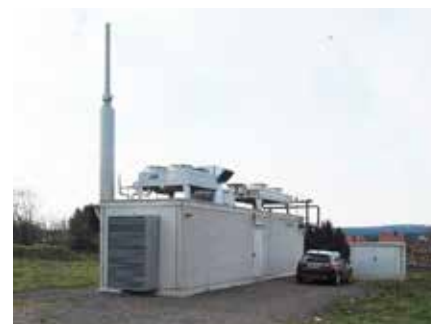
Benneckstein (Germania) - Recupero termico da camicie e fumi di scarico di gensets a biogas
