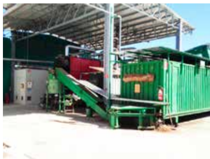
Sommalombardo (VA) - Produzione elettrica da caldaia alimentata a biomassa (scarti di segheria)
