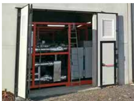
Città della Pieve (PG) - Produzione elettrica da caldaia alimentata a biomassa (sfalci di potatura)
