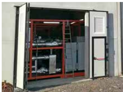
Città della Pieve (PG) - Produzione elettrica da caldaia alimentata a biomassa (sfalci di potatura)
