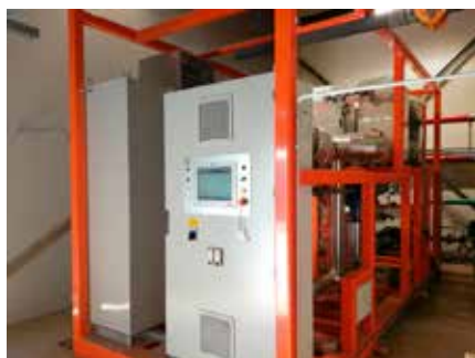
Rovato (BS) - Produzione elettrica da caldaia alimentata a biomassa (pallet a fine vita)
