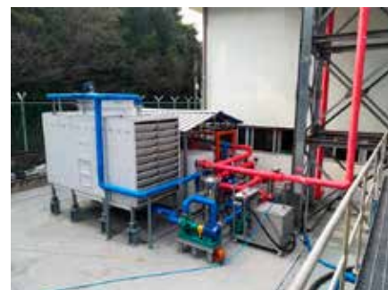
Heuksan (Corea del Sud) - Recupero termico da centrale termoelettrica (generatori ad olio pesante)
