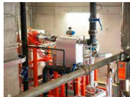
Mestre (VE) - Recupero termico da caldaia a biomassa e da turbine ad aria calda
